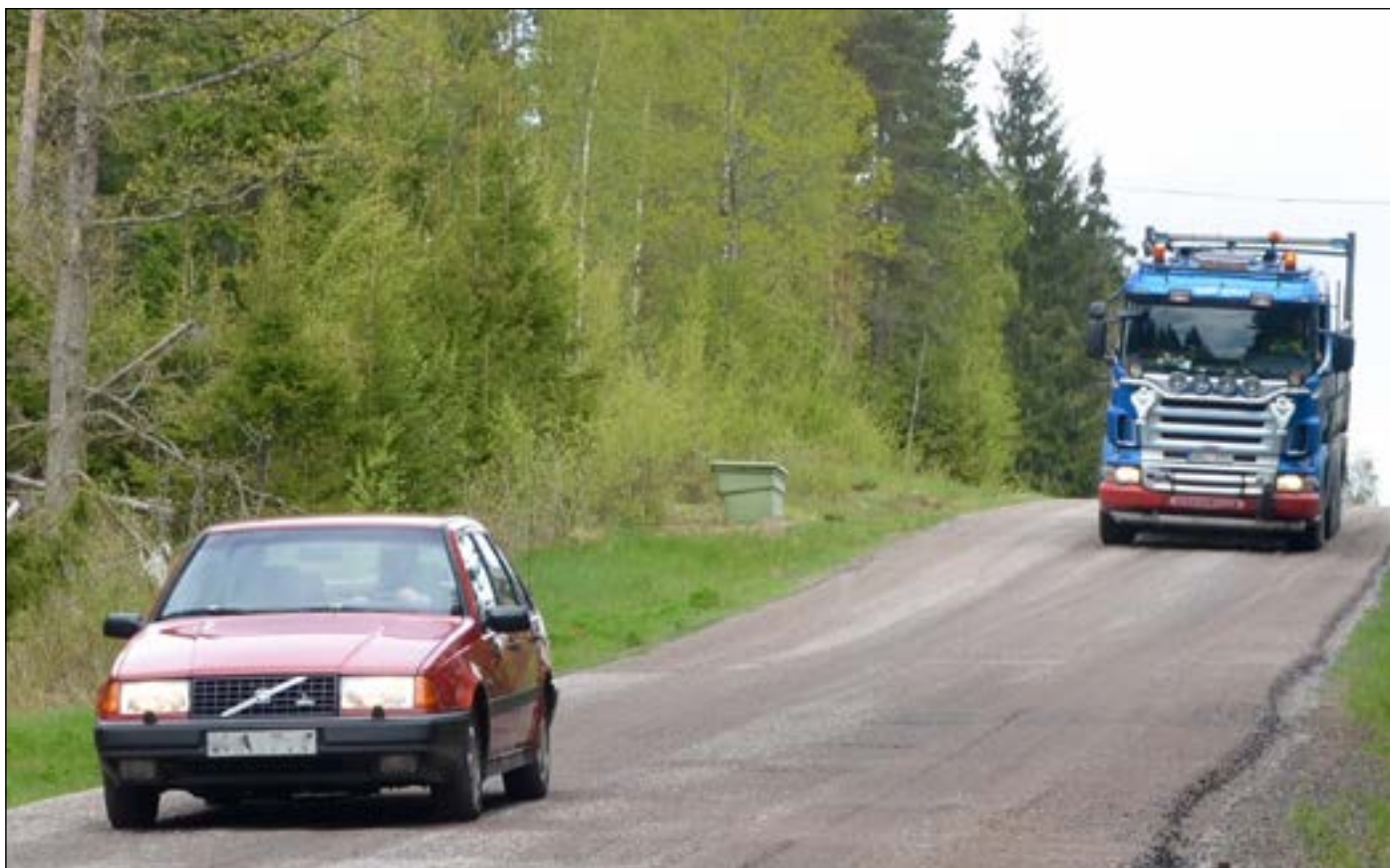
När tunga transporter kör på enskilda vägar bildas ofta spår. Dikena förstörs lätt när vägkroppen trycks utåt av belastningen.
