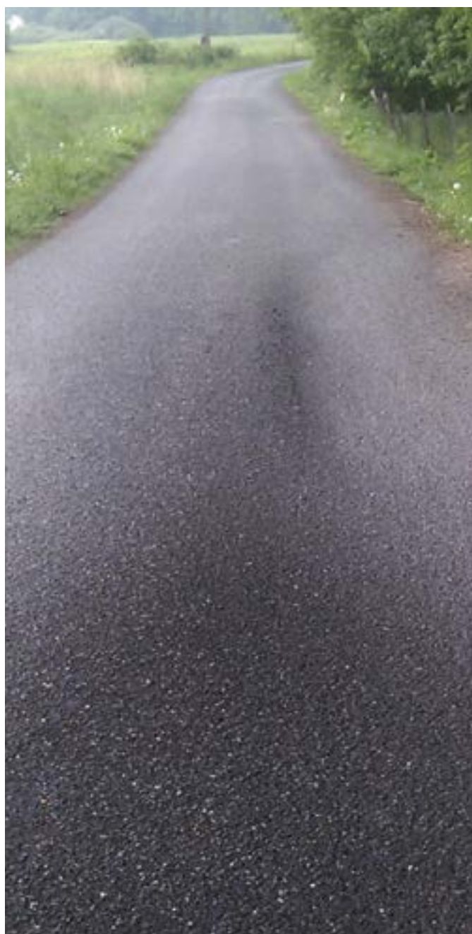
Norrängens belagda vägar vilar på gammal sjöbotten och är därför mycket känsliga för tung belastning.
